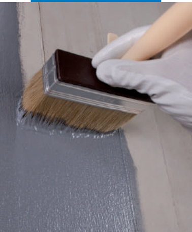
Aplicación de Eco Prim Grip con brocha sobre un soporte de hormigón
